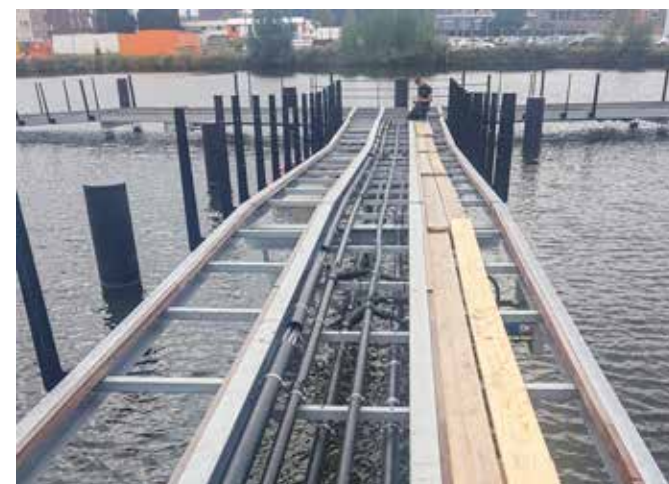
De installatievoorzieningen in de steiger.
