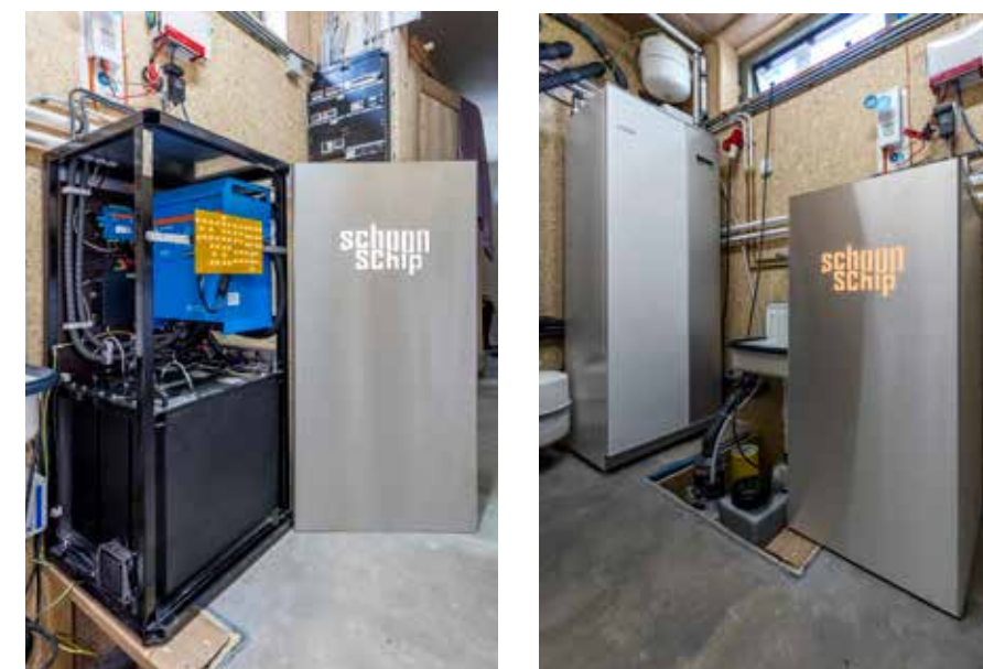
In opdracht van SpectralUtilities levert marktleider in energieopslag Top Systems B.V. de lithium accusystemen voor de waterwoningen, inclusief de beveiligingen, energie-omvormers en besturingssystemen.
